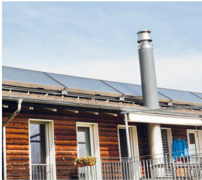
Die thermische Sonnenenergienutzung kann beim Heizungsersatz ein anderes Heizsystem sinnvoll ergänzen.
