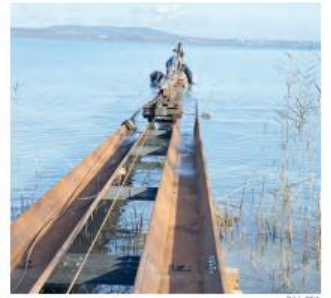
Auf dieser Schiene werden die Rohre nach und nach ins Wasser gelassen.
