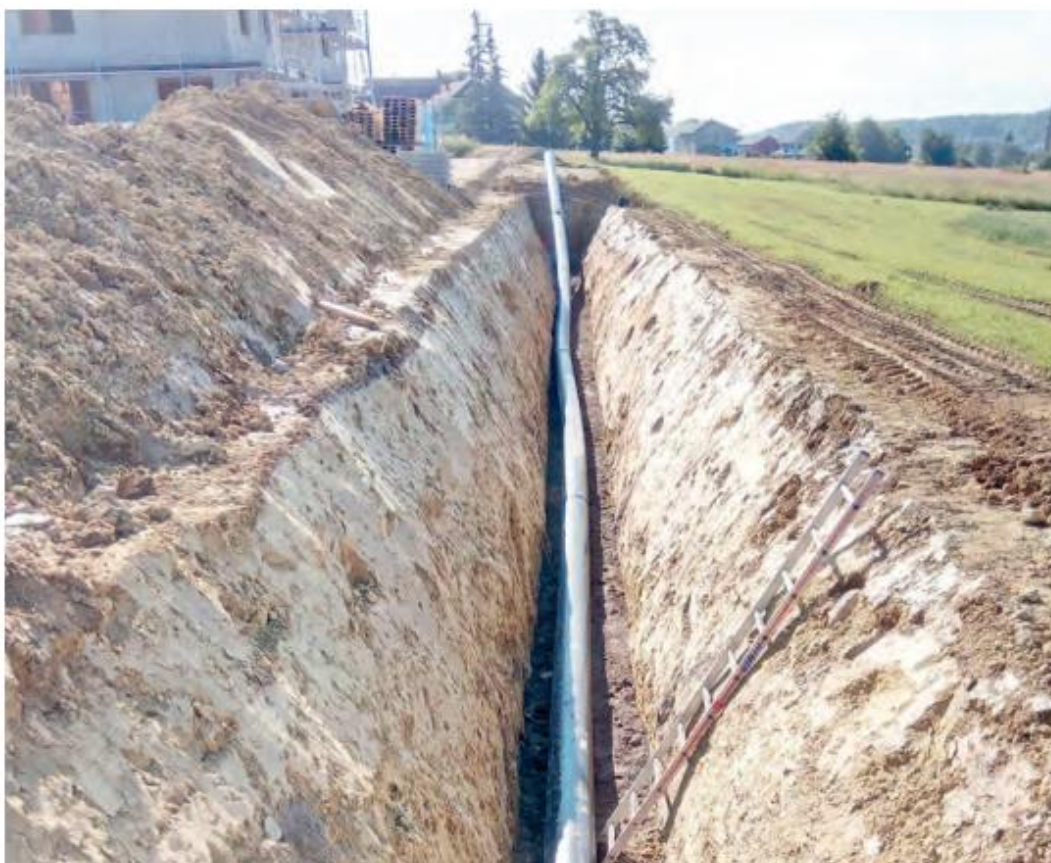
Die Brauchwasserleitung bei der Ringgishalde-Überbauung in Auenhofen.
